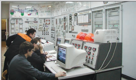
Щит управления Казанской ТЭЦ-2. 2004 год
